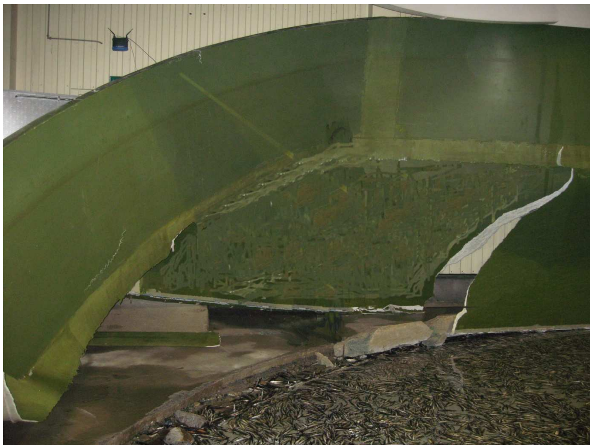
Bilde 1: Viser karet etter hendelsen. Elementer var revet i stykker, skjøter var revet fra hverandre og vegger var "brettet" ut og revet opp fra betongstøtten på utsiden. Deler av bilder er retusjert for å anonymisere en ansatt.
